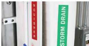
Nhãn đánh dấu đường ống
